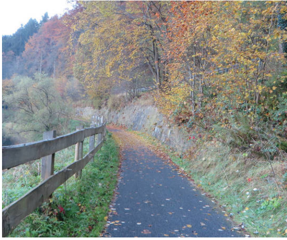
Bild 3: Enge RVA zwischen Mauer und Geländer: Mit dem letzten Stück Wegeausbau im Bereich Fuldaschleife Wahnhausen auf 3 m Asphaltbreite wird insbesondere die Nutzerzahl der Inline-Skater aber auch der Radfahrenden weiter ansteigen, da die Strecke Hann. Münden <-> Kassel dann durchgängig asphaltiert ist. Eine Verbreiterung auf durchgehend 3 m ist daher notwendig.
