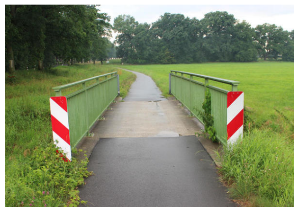
Bild 4: RVA Beeskow – Krügersdorf entlang der B246: Vorbildliche Absicherung der Geländerstöße des grün „getarnten“ Brückengeländers.
