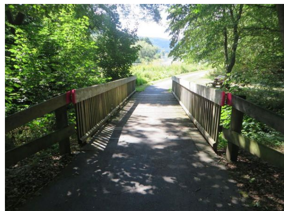
Bild 2: Im Schatten schwer zu erkennen: die Geländerstöße
