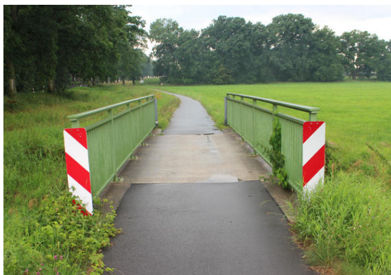
Bild 3: RVA Beeskow – Krügersdorf entlang der B246: Vorbildliche Absicherung der Geländerstöße des grün „getarnten“ Brückengeländers.
