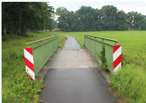
Bild 3: RVA Beeskow – Krügersdorf entlang der B246: Vorbildliche Absicherung der Geländerstöße des grün „getarnten“ Brückengeländers.
