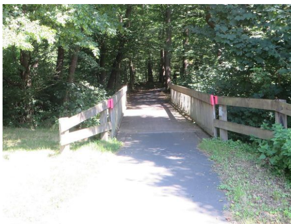
Bild 3: Jemand hat die Geländerstöße hier provisorisch mit etwas roter Farbe hervorgehoben. Leitbaken kann das allerdings nicht ersetzen.
