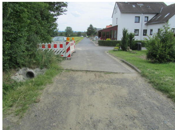
Bild 2: Südende der Maßnahme: hier findet sich ein problematischer Übergang vom Schotterweg in die Asphaltstraße.
