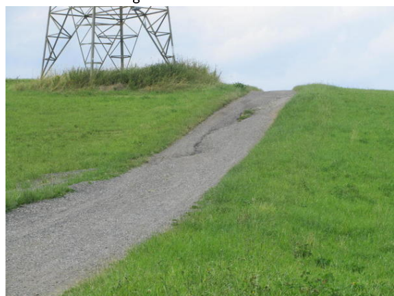
Bild 4: Blick auf die Erosionsrinne.
