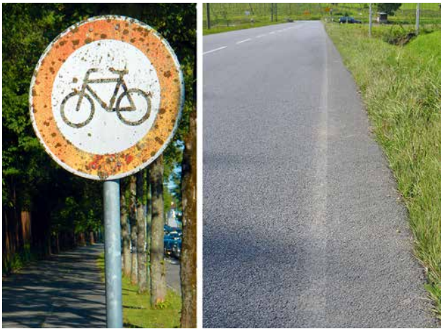
Verrostetes Verkehrszeichen und verblasste Fahrbahnmarkierung
