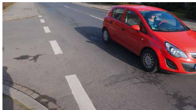
Unterbrochene Markierung des Fahrbahnrandes im Zuge einer Vorfahrtstraße
