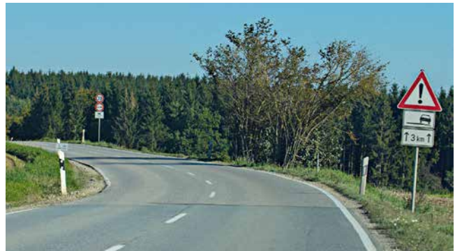
Warnung vor unzureichender Befestigung des Fahrbahnrandes
