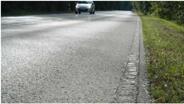
Fahrbahnmarkierung (schlechter Zustand)
